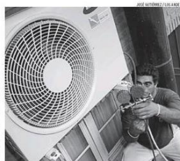
FUNDAMENTAL. Ventilación adecuada y limpieza de filtros.
