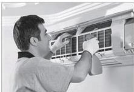
LIMPIAR LOS FILTROS. Es fundamental para no contaminar el aire.
